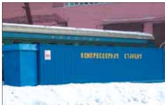
Станция на базе блок-бокса с габаритами 40-ка футового контейнера
