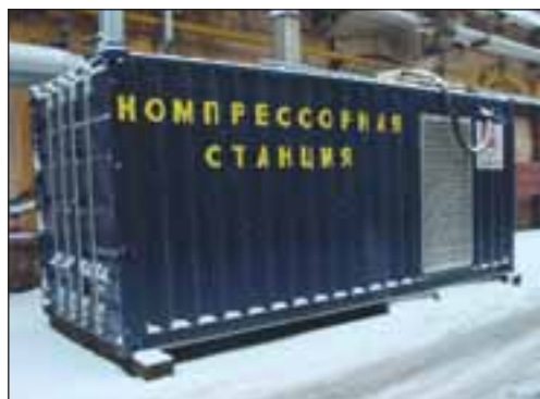
Станция на базе блок-бокса с габаритами 20-ти футового контейнера
